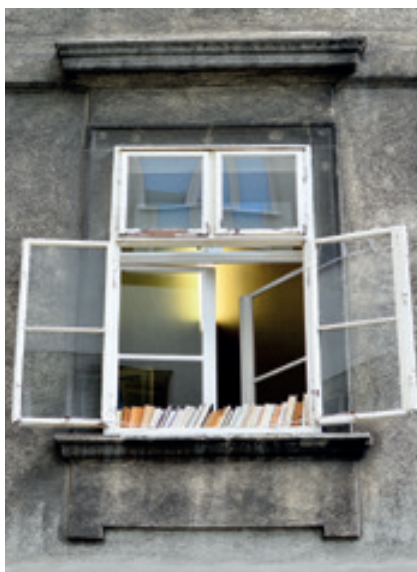
Bei Kastenfenstern soll die Dichtigkeit von innen nach außen abnehmen.
