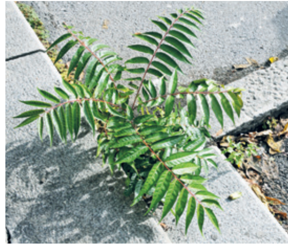
Der Götterbaum keimt in Gehsteigfugen und sollte beseitigt werden.
