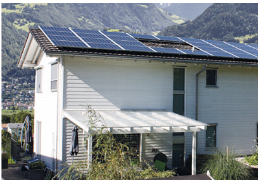
Photovoltaikanlagen auf dem Dach sind eine kostengünstige Möglichkeit zur Stromerzeugung.
